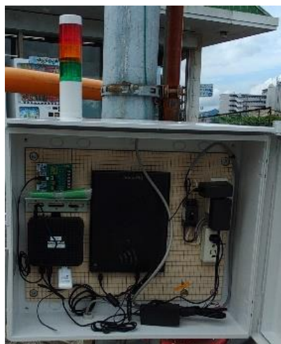
〔写真〕機器内部
